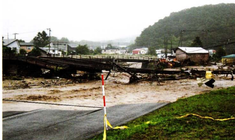
洪水で崩落したJR鉄橋
